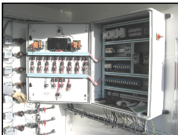
Figure 21 : Photographie des unités d'injection (à droite : unité d'injection du nanofer / à gauche : unité d'injection de la dithionite et automat)
