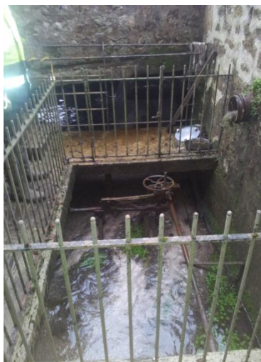
Chambre de répartition et arbre de transmission du moulin à prière
