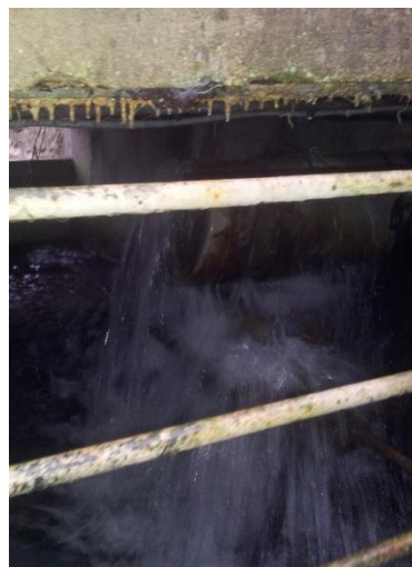
Sortie de la canalisation sur la microturbine *
